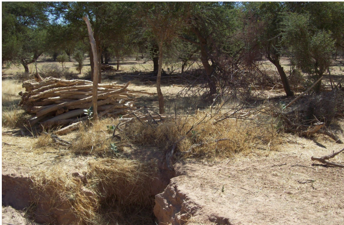
9. Un puits traditionnel effondré pendant la saison des pluies. Il sera réhabilité par la CA.
