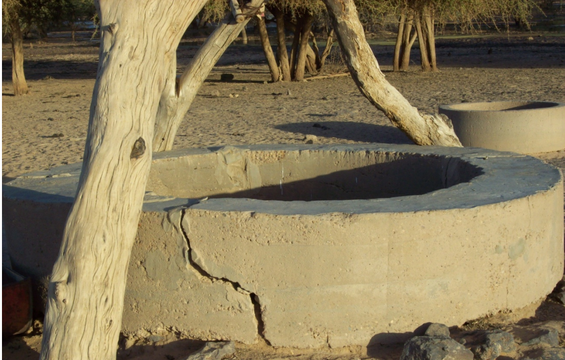
2. Puits endommagé par les pluies à Ekawel
